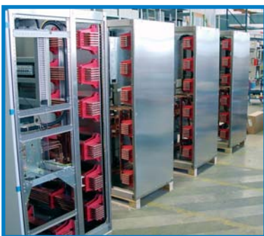
2 x 6300 A Doppel-Sammelschienenfelder mit geschlossener Rückwand
