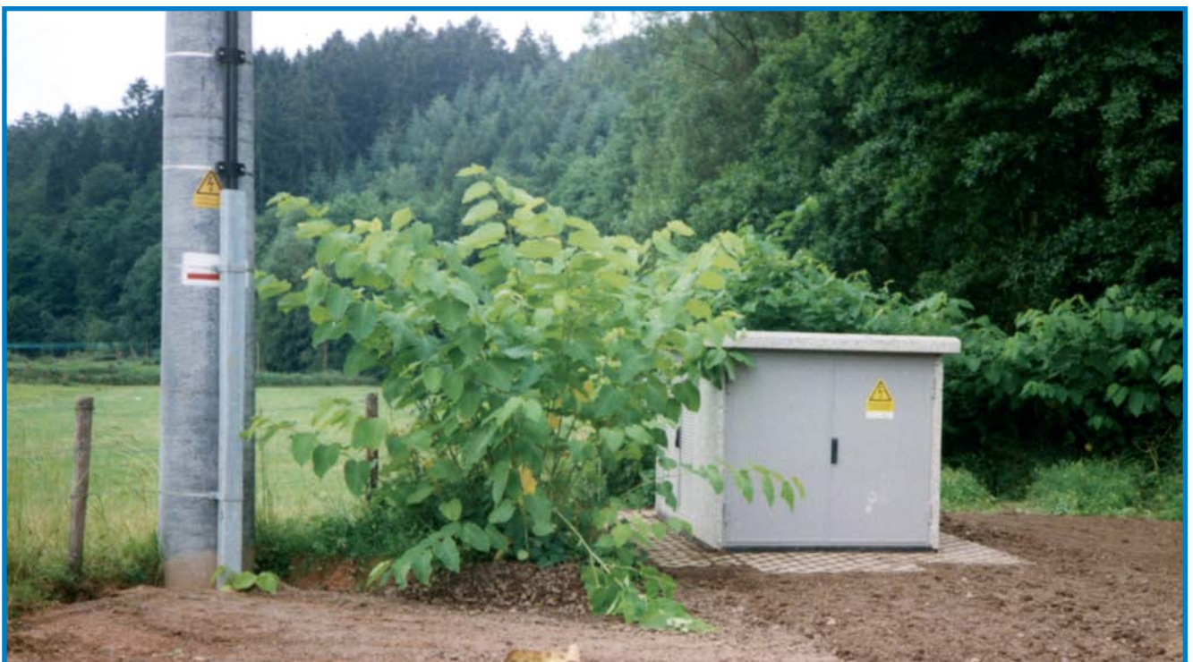
Vom 20 kV-Mast zur 20 kV Kompaktstation und von dort zu einem Tiefbrunnen ▲
