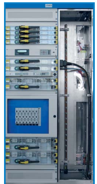
▲ Abgangsfeld mit Schaltersicherungsleisten
