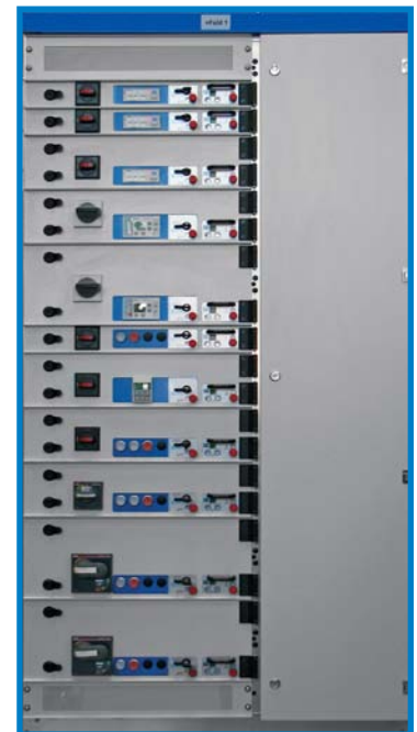
▲ MCC-Abgangsfeld für Motor- und Kabelabgänge
