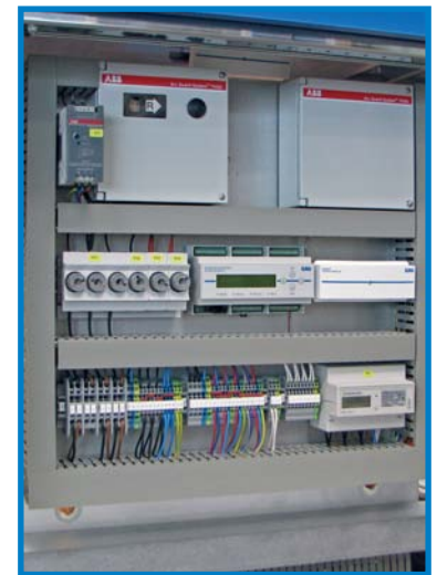
Steuerzentralen für Lichtbogen- und Rauchgaswächter ▶
