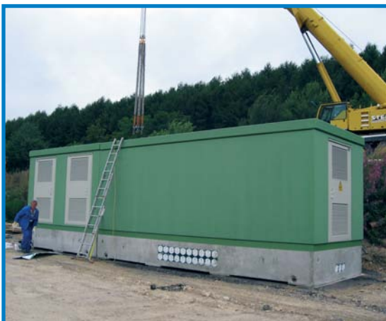
Fertige begehbare Transformatoren-Station ▼
