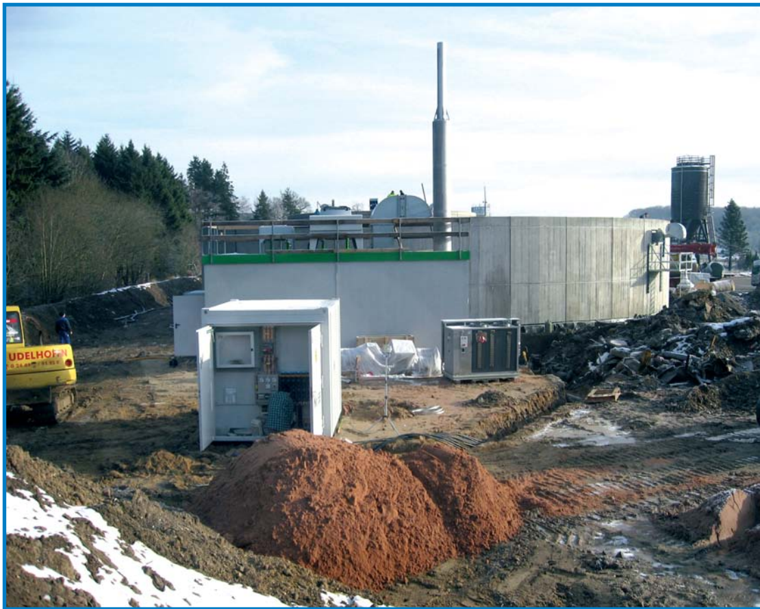
Baustrom-Container-Transformatorstation für eine Biogasanlage
