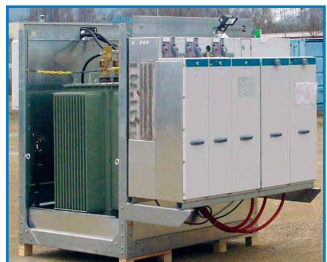
Die Mittelspannungsseite Kabel - Kabel Trafoschalter Hochspannungsmessung ▶
