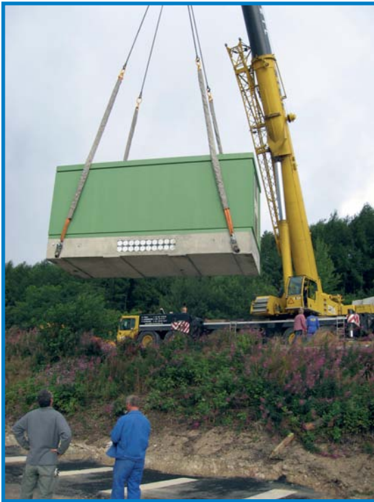
Übergabe – Station aus zwei Gebäudeteilen Mittel-, Niederspannung und Transformatorgebäude ▲
