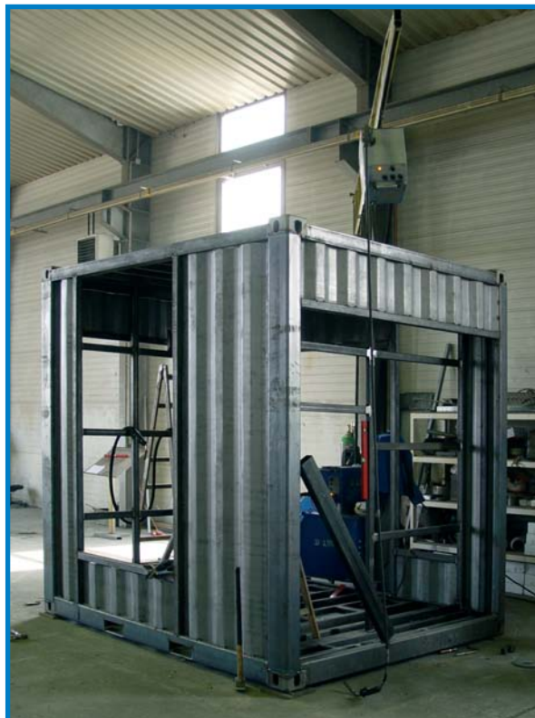
▲ Bereits beim Containerausbau legen wir größten Wert auf Qualität und äußerste Maßhaltigkeit
